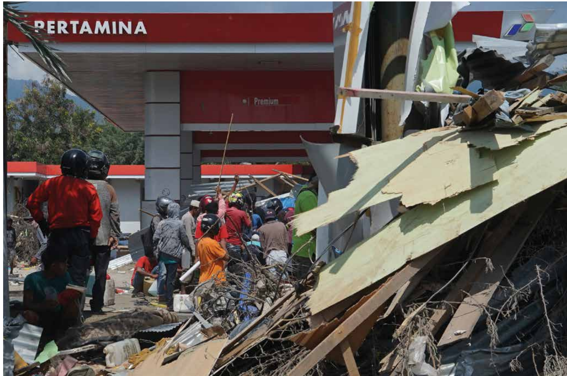
▲ SPBU Pertamina di Jalan Mamboro, Palu yang rusak parah karena diterjang gempa dan tsunami.
