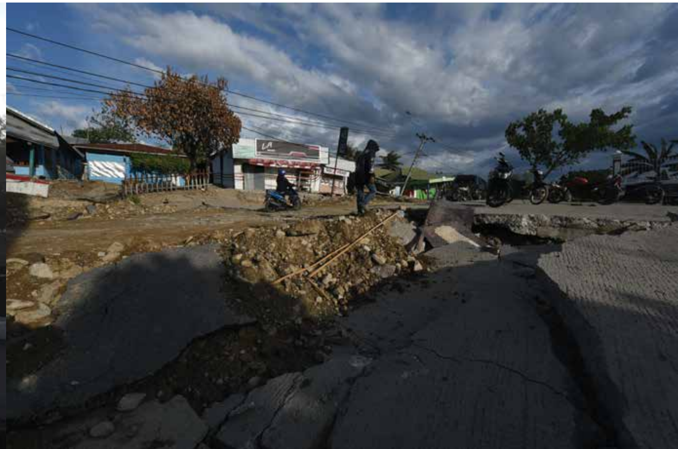
▲ Salah seorang warga melihat kondisi jalan yang retak akibat gempa berkekuatan 7,4 SR yang mengguncang kota Donggala, Sigi dan Palu-Sulteng.
