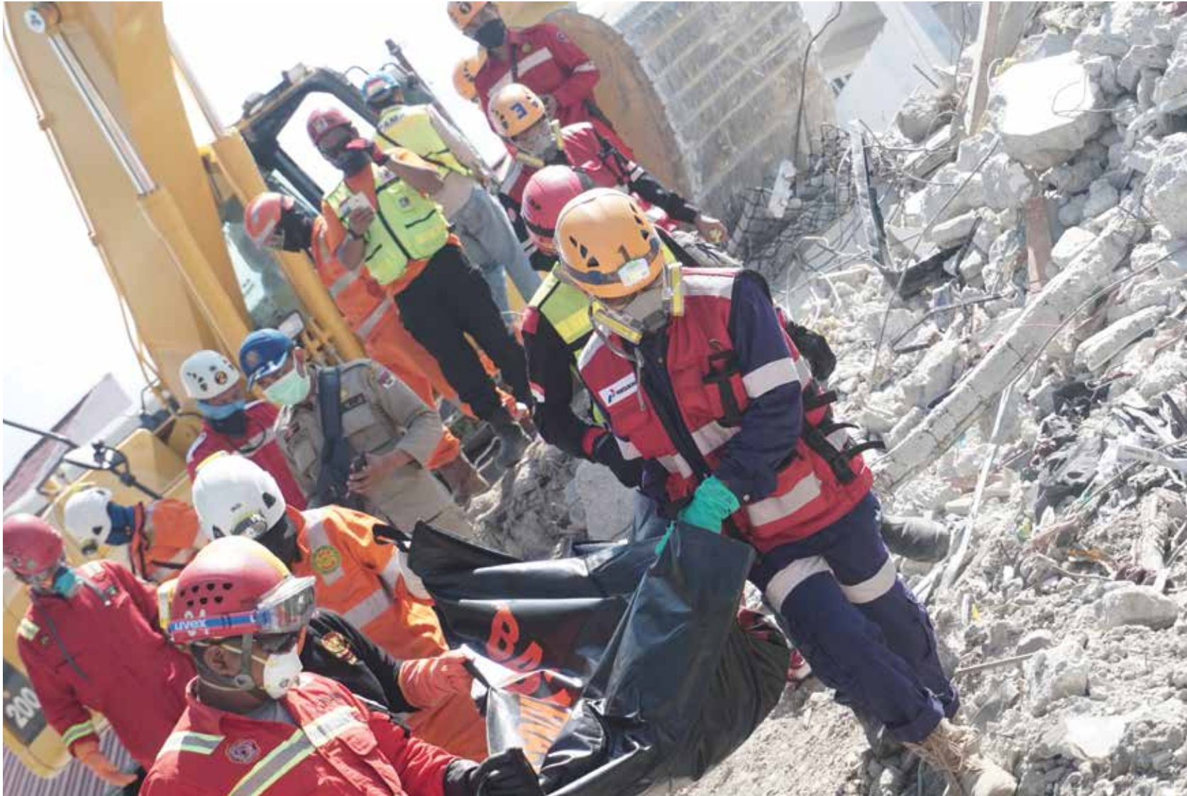
▲ Emergency Response Team Pertamina melakukan evakuasi korban meninggal yang tertimpa bangunan bersama Basarnas.
