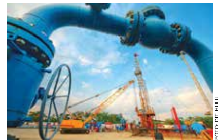
Kegiatan Perawatan Sumur di Lapangan Sukowati pad A, PEP Asset 4 Sukowati Field.
