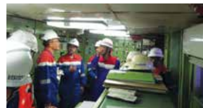
VP Commercial Hadi Purnomo melakukan peninjauan di kamar mesin MT Mangun Jaya
