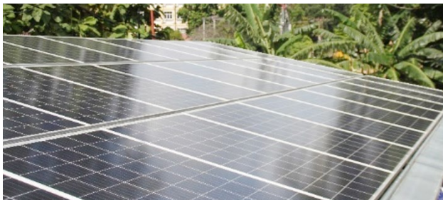
Sumber Energi Berbasis Panel Surya
