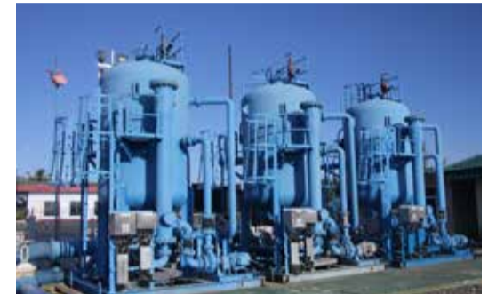
Fasilitas produksi di Stasiun Pengumpul Utama Bunyu Field, Pulau Bunyu
