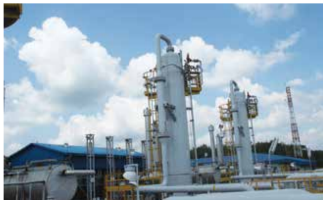
Fasilitas produksi Stasiun Pengumpul Gas (SPG) Musi Timur Pendopo Field, Sumatera Selatan.
