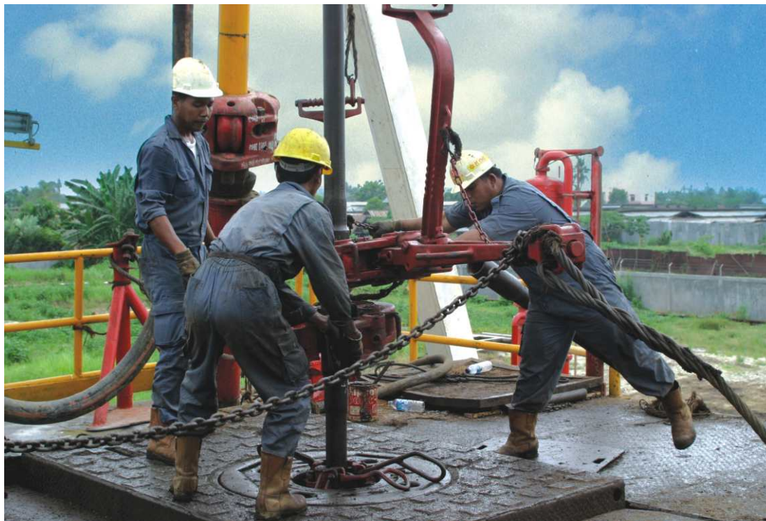
Area Operasi Pangkalan Susu-DOH NAD Sumatera Bagian Utara
